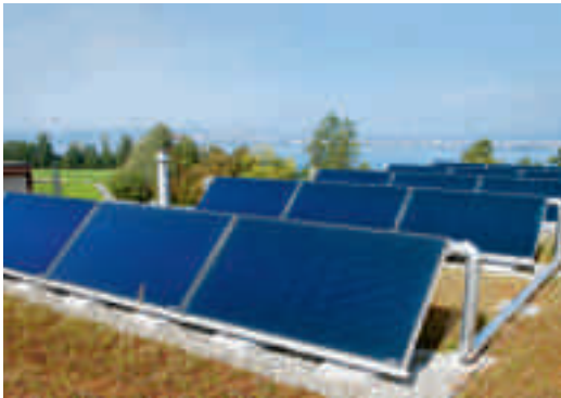
Die hauseigene Solaranlage erzeugt etwa 40% des Heiz- und Brauchwasserverbrauchs.
